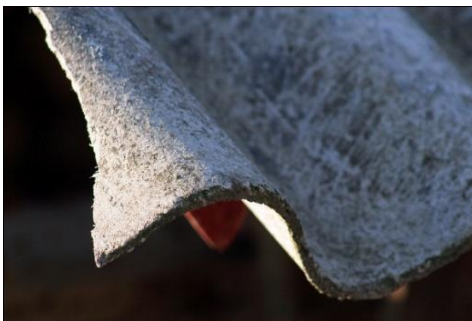
Zdjęcie 7 Płyty faliste azbestowo-cementowych
