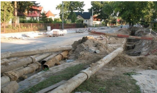
Zdjęcie 9 Rury azbestowo – cementowe
