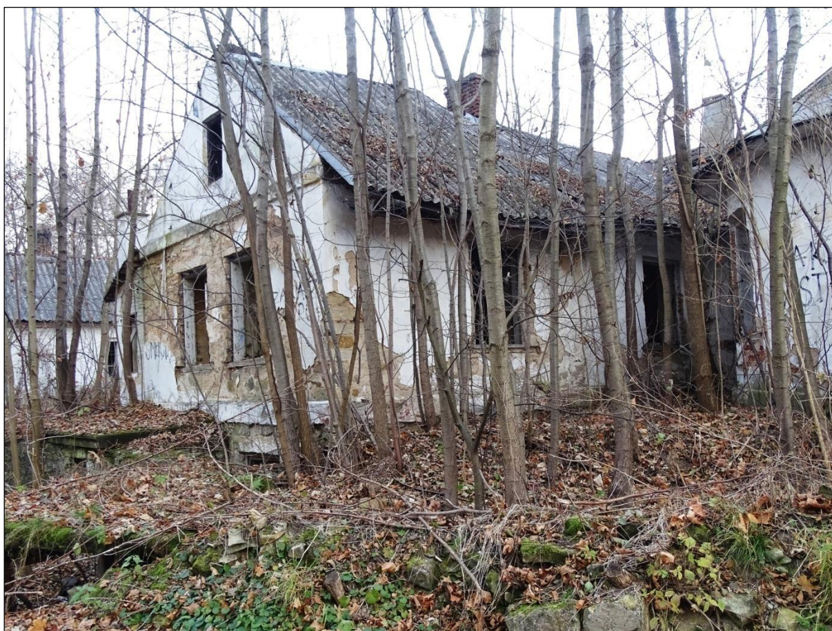
Ruiny budynku administracyjno-mieszkalnego
